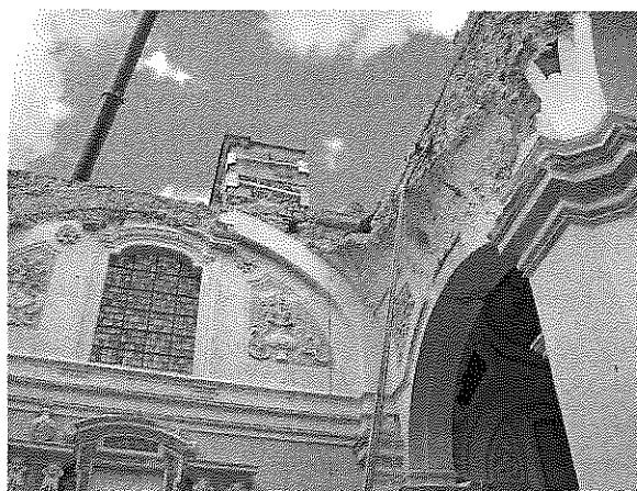
Basilica di Collemaggio - Veduta crolli con affreschi
