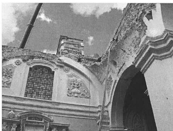
Basilica di Collemaggio - Veduta crolli con affreschi
